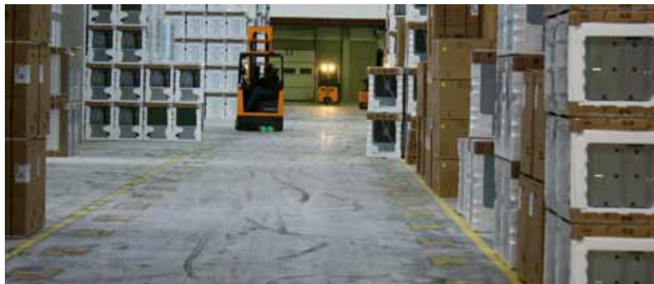
Utilisation intensive par BOSCH SIEMENS du dallage sur un site développé par ARGAN
